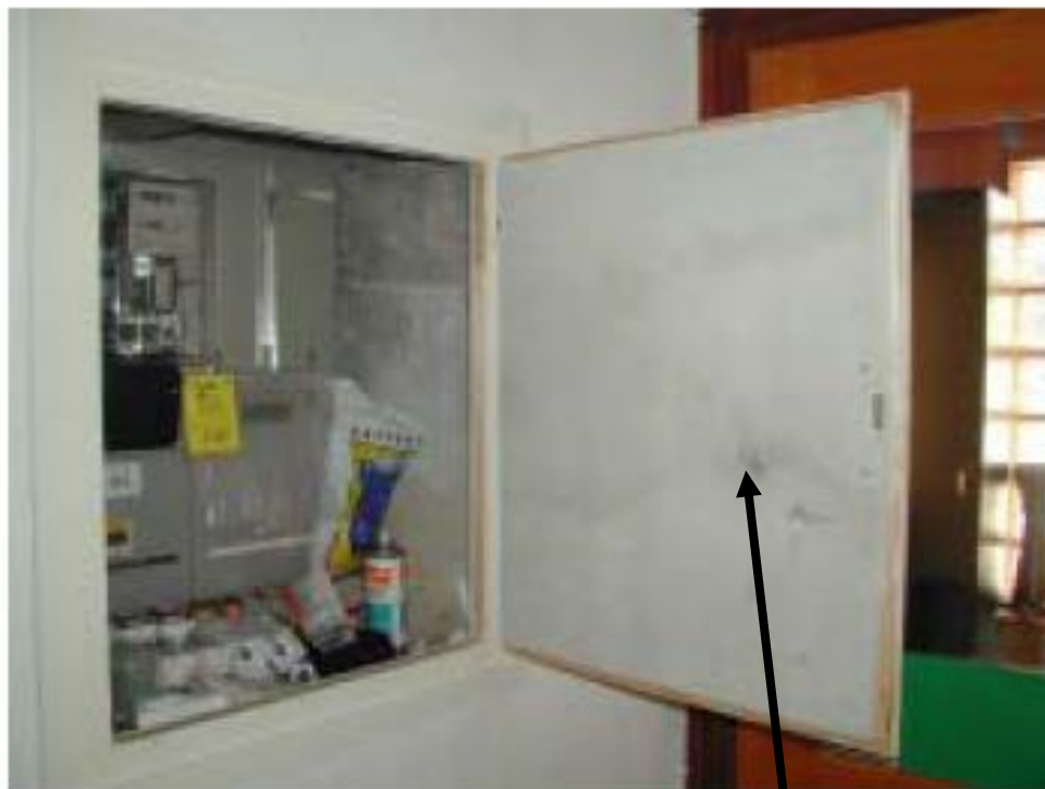
Scatola dei fusibili con lastra antincendio all'amianto sulla porta interna, foto: JMF/SLE, IST
