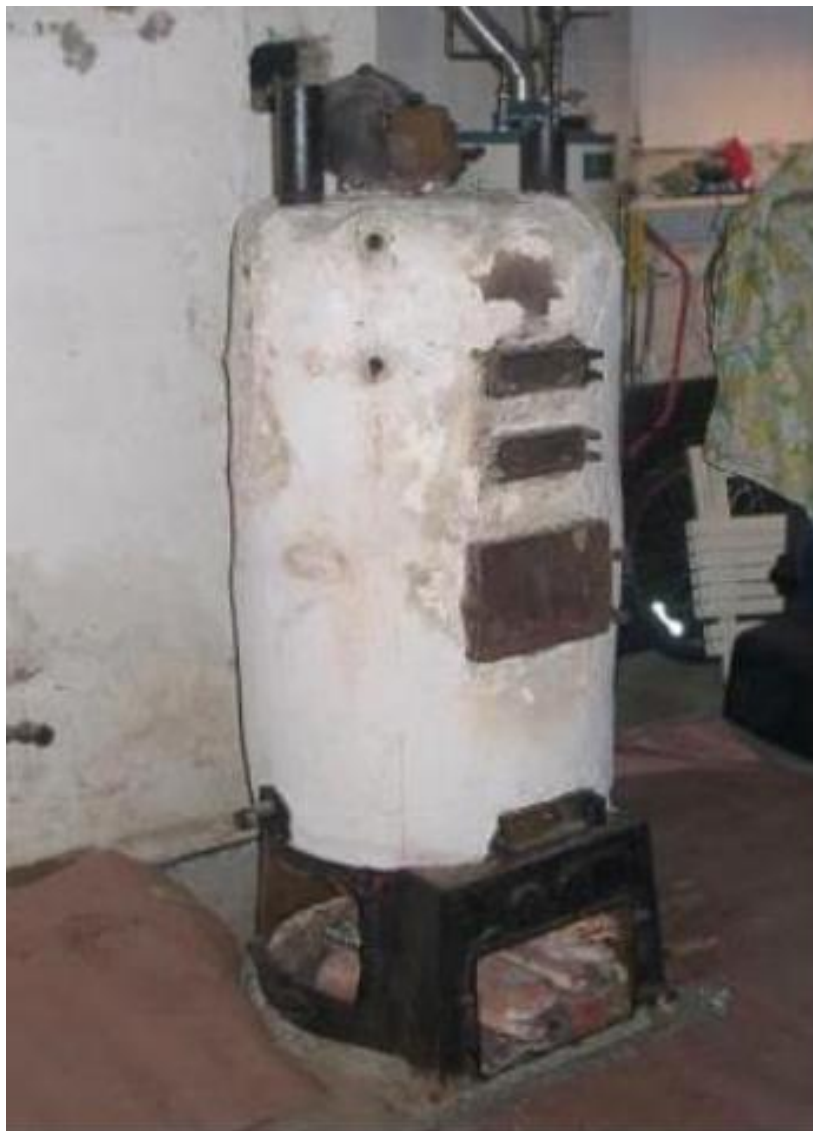
SCALDABAGNO RIVESTITO IN AMIANTO
