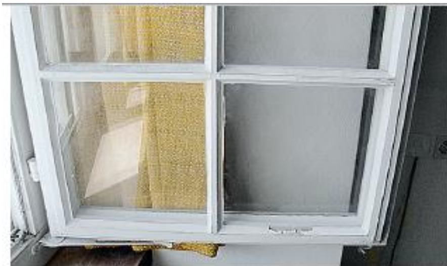
Stucco per finestre contenente amianto Stucco per finestre (stucco a base di olio di lino).
