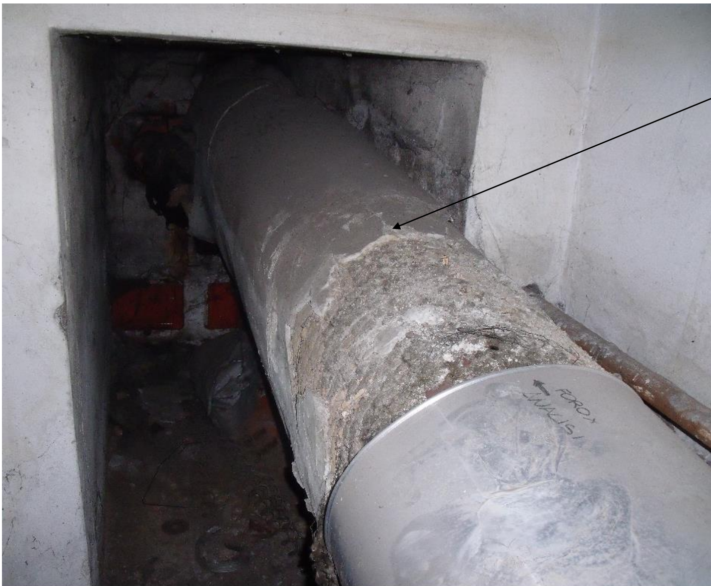
TUBAZIONE RIVESTITA DI COIBENTE CONTENENTE AMIANTO In questo caso si parla di amianto friabile
